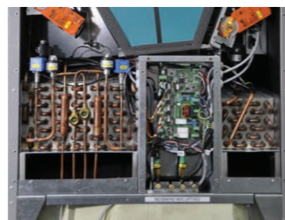
Výměník tepla a zásobník kondenzátu
